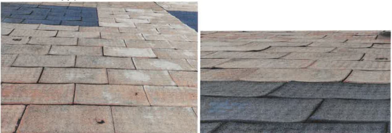
Odształcenie całej powierzchni placu zabaw
