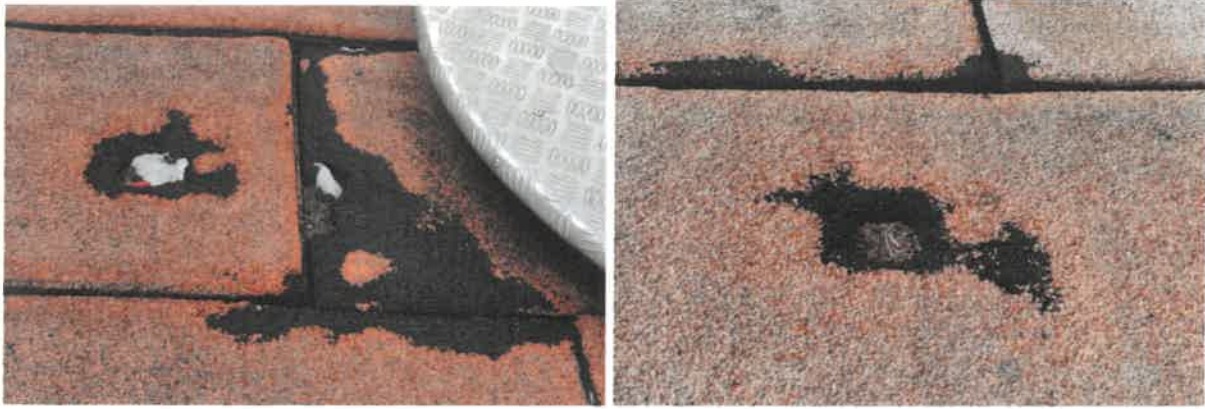
Liczne ubytki w powierzchni
