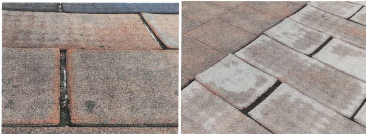
Szczeliny pomiędzy prostokątnymi elementami nawierzchni
