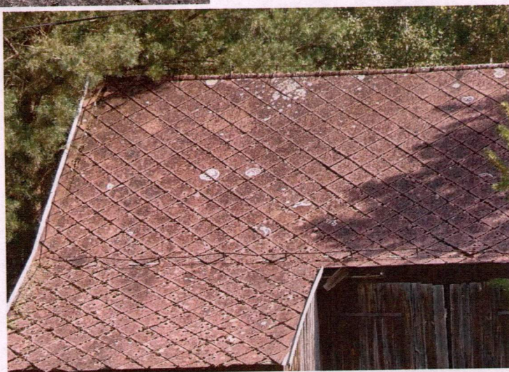
Rysunek 1. Wyroby azbestowo-cementowe: na górze z lewej- płyty faliste, na dole po prawej- płyty płaskie (źródło: materiały własne).
