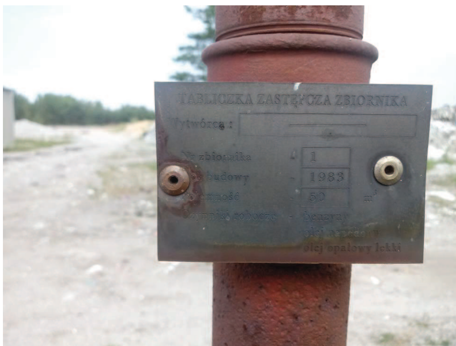
Fot. 5. Tabliczka zastępcza zbiornika (Nr zbiornika 1, rok budowy 1983, pojemność 50m 3 , czynniki robocze – benzyny, olej napędowy, olej opałowy lekki)
